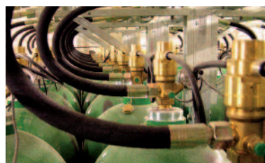
Борьба с пожаром (газовое тушение)
