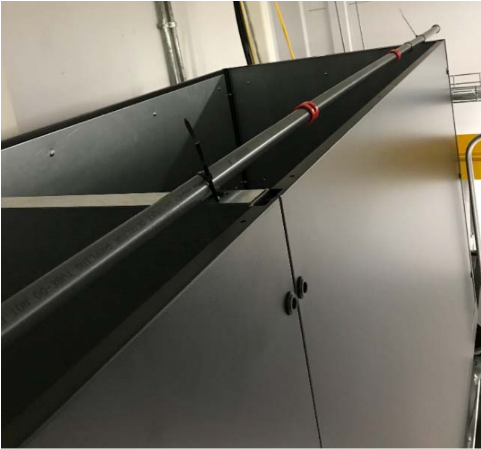
Рис. 4.4.2, Пример расположения аспирационных труб и отверстий на входе «горячего воздуха» в прецизионные кондиционеры
