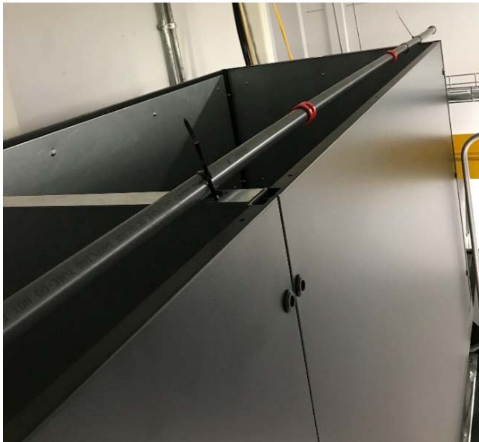
Рис. 4.4.2, Пример расположения аспирационных труб и отверстий на входе «горячего воздуха» в прецизионные кондиционеры
